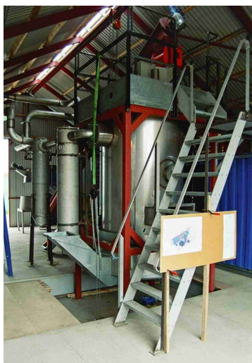
Castor anlæggets trinopdelte gasgenerator
